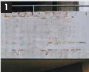
Typische schade bij onvoldoende beschermd beton
